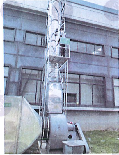
有组织废气处理后排放口©1# (DA001)
