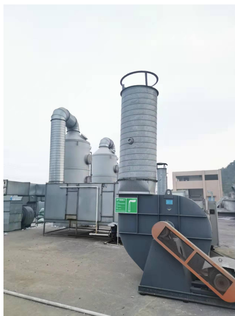
面漆房废气处理设施
