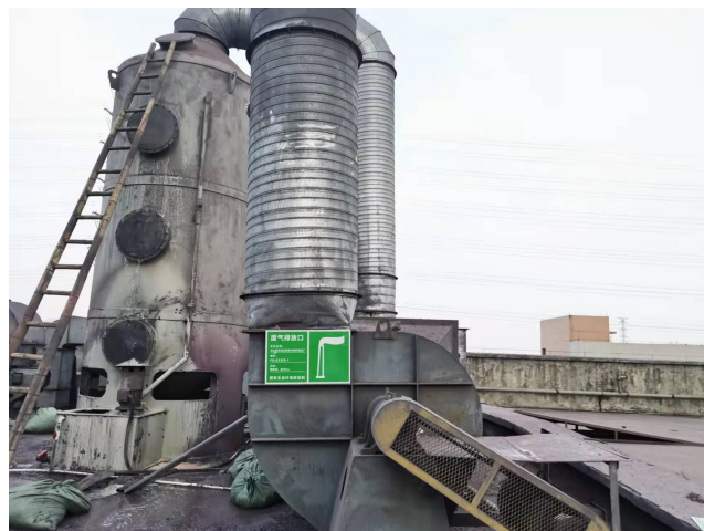
底漆房废气处理设施
