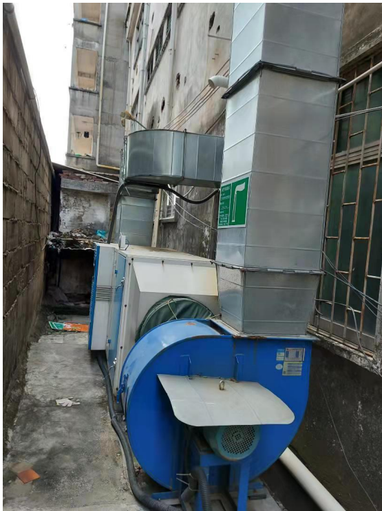
废气处理设施
